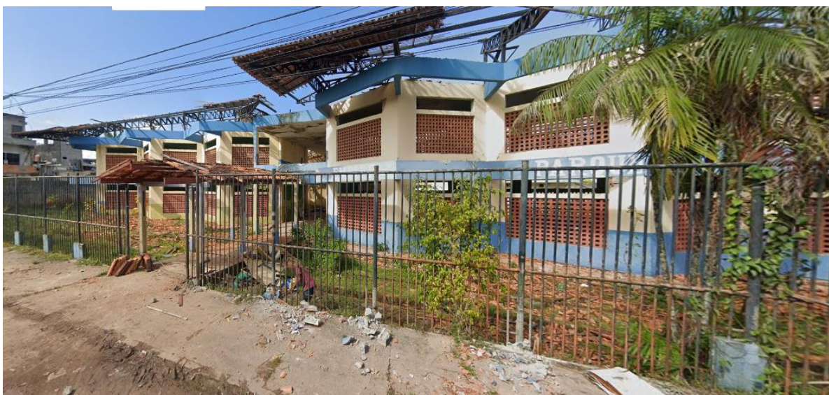
Figura 17 - Fachada deteriorada da Escola Parque Amazônia da Terra Firme
